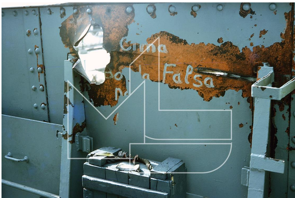
Uma outra perspectiva do rombo a partir do corredor interior da ponte, próximo do suporte da MG 42 de estibordo
